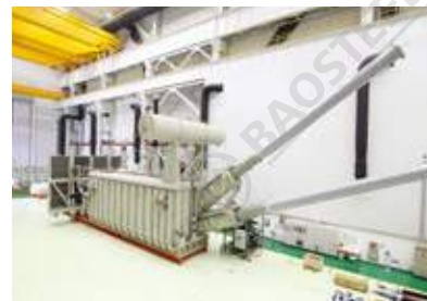
±800kV换流变压器 ±800kV Converter transformer
