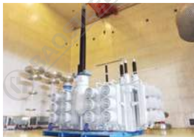
1000kV交流变压器 1000kV AC transformer
